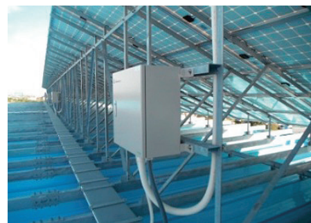
パワーコンディショナーの設置状況
