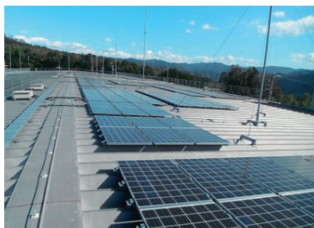
太陽電池モジュール設置状況②
